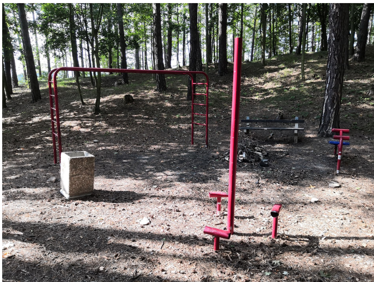
Fotografie stávajících workoutových konstrukcí určených k odstranění.
