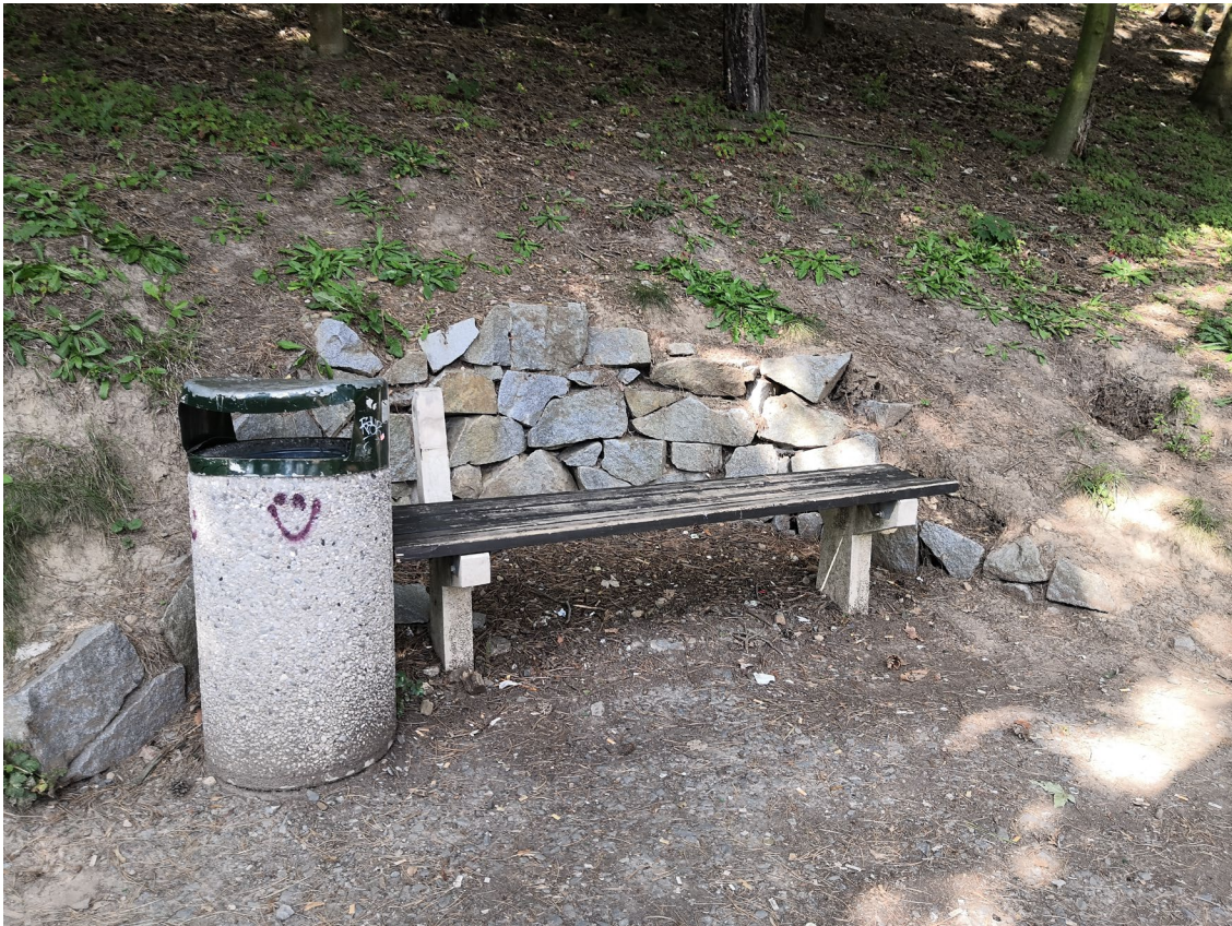
Bude provedeno odstranění stávajících laviček s odpadkovými koši, včetně zapravení kamenné opěrné stěny.
